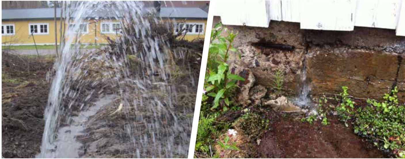
Hvis de privateide rørene i bakken utenfor huset ditt springer lekk, er det sannsynligvis ditt ansvar å bekoste utbedringen, selv om deler av rørene ligger under offentlig vei.
