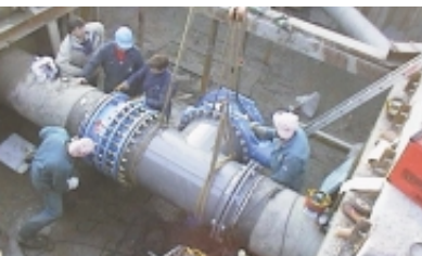
Store rørsystem ved Eikern-utbyggingen.
