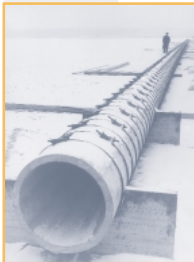
Store forhold – her en sugeledning fra århundreskiftet.
